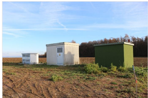
6) Transformatoren © Klärle GmbH 2025
